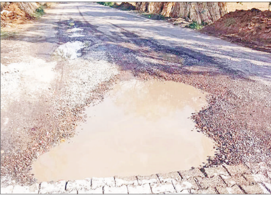
नांगल चौधरी। नायन बस स्टैंड के पास क्षतिग्रस्त सड़क मार्ग। फोटो: हरिभूमि
